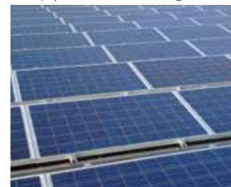
Ecole d'Offenburg (D) Année de construction 2010 Puissance 32 kWp
