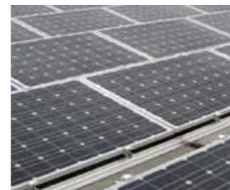
Ecole primaire de Heidesheim (D) Année de construction 2010 Puissance 115 kWp
